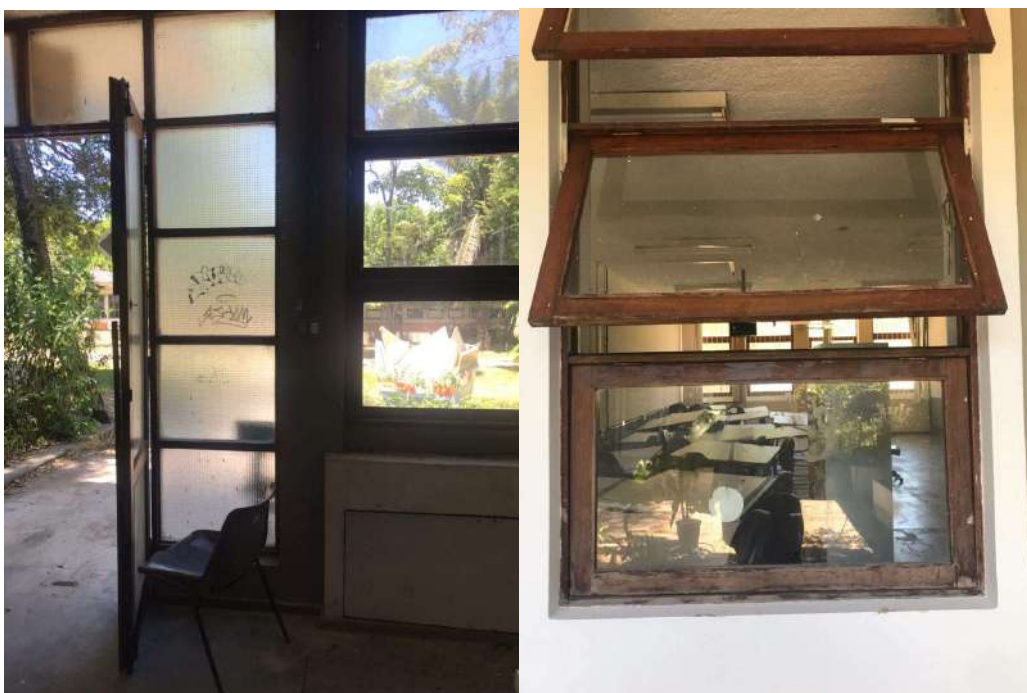
Porta de acesso e esquadrias. Fonte: Autor do laudo.
