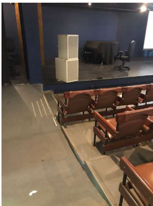
Ausência de sinalização na circulação (Autor do laudo).
