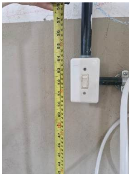
Instalações (Autor do laudo).
