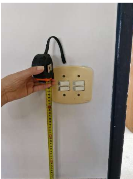
Instalações e comandos. (Autor do laudo).
