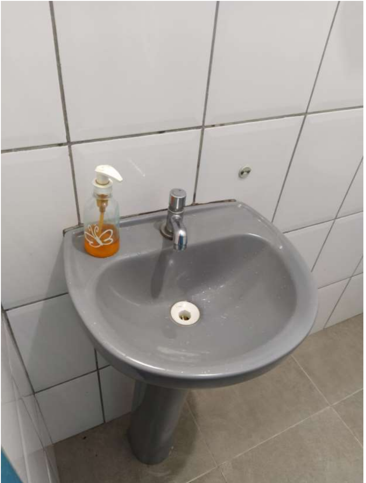
Banheiro: Prédio Tijolinho
