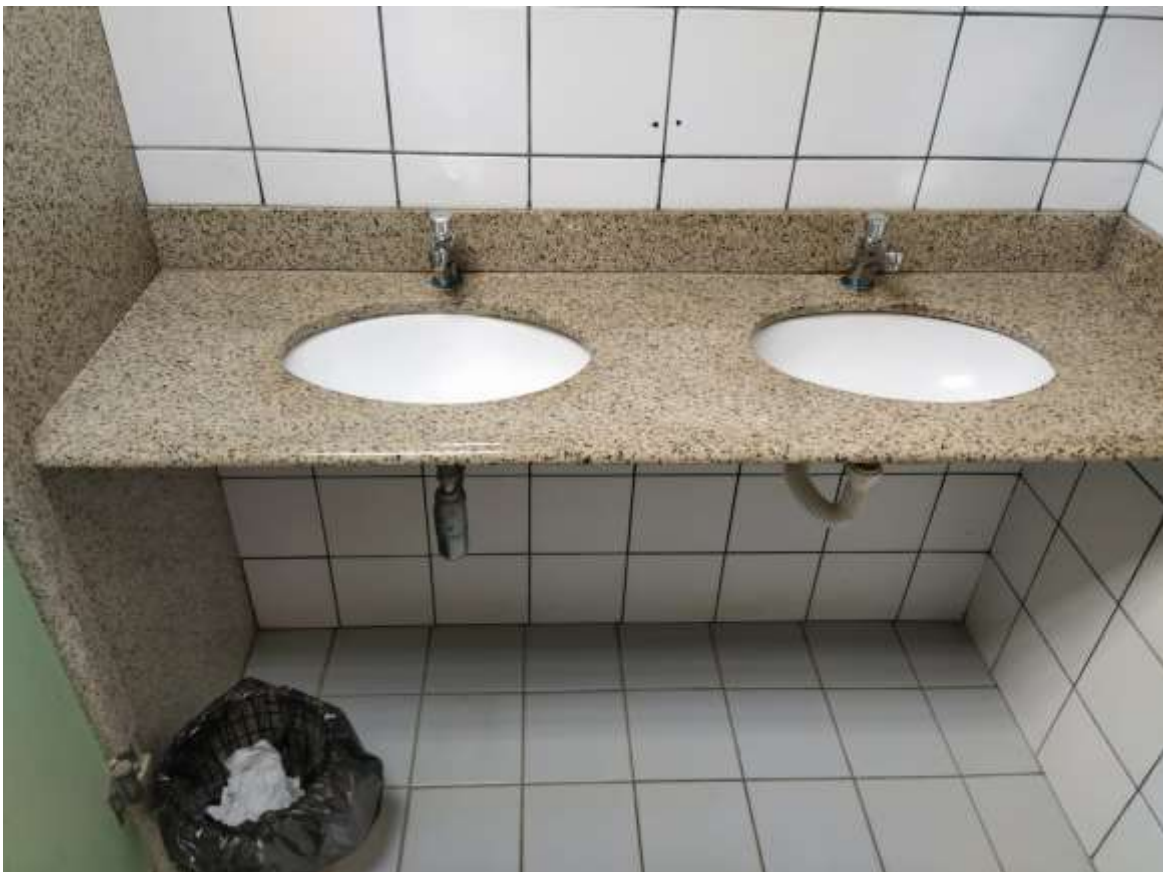
Banheiro: Prédio Tijolinho
